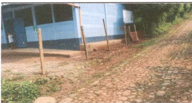
Foto 5: Reparación de muro perimetral de bloc con tubo hg y malla galvanizada, soleras intermedias y columnas
